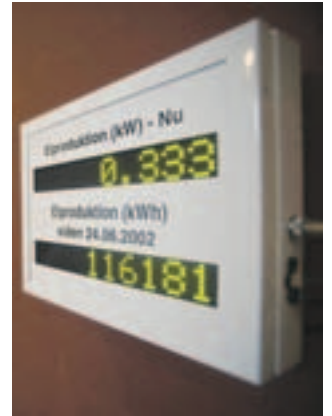
På denne måler, som sidder i 3Fs reception, kan man se, at der siden 24.6.2002 er hentet 116.181 kWh fra solcellerne på taget
