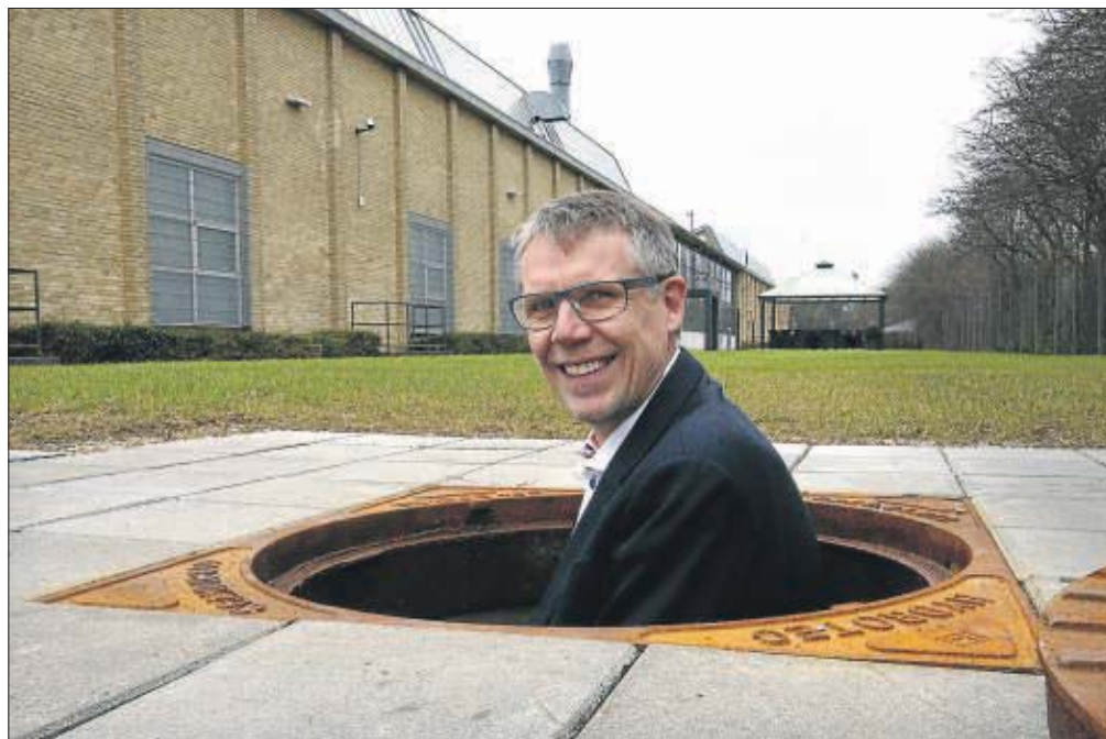
Interxion investerede sidste år i et topmoderne køleanlæg, der rækker 70 meter ned til grundvandet under datacentret. Det virker rigtig godt, fastslår direktør Peder Bank. Foto: Kim Rasmussen
