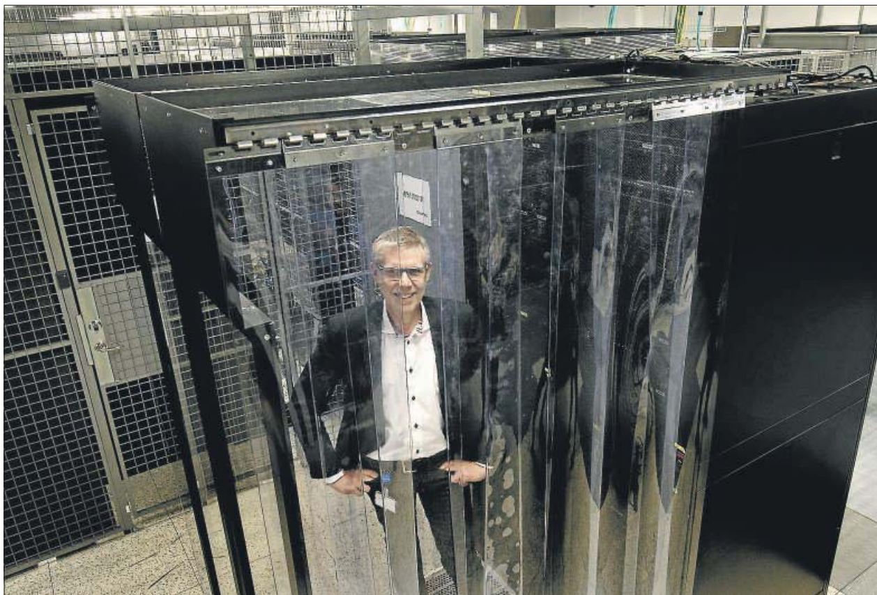
Hos Interxion i Ballerup med Peder Bank i spidsen fordeler teleselskabers, medieselskabers og store offentlige instansers og private virksomheders servere sig i rum på tilsammen 3500 m 2 .
